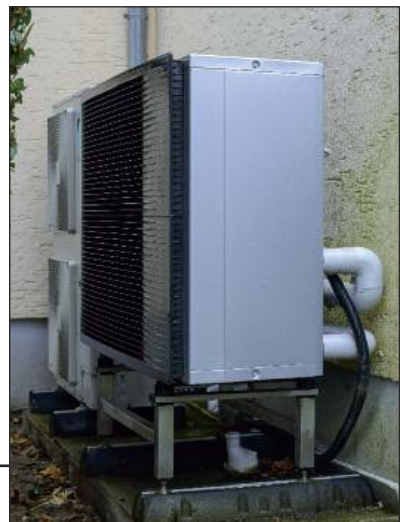
Außeneinheiten der Luft-Wasser-Wärmepumpe und des VRV-Systems zur abgestimmten Beheizung des ehemaligen Kirchenschiffs.
