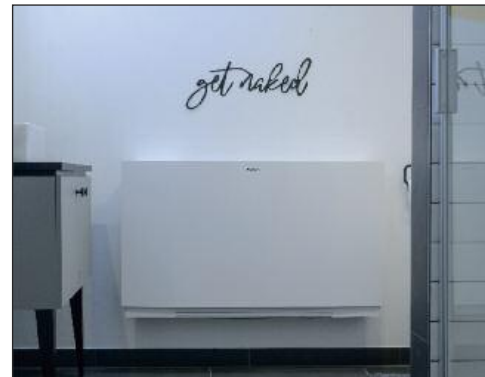
Die Daikin Altherma HPC Konvektoren im Bad sorgen für schnelle, gleichmäßige Wärmeverteilung.
