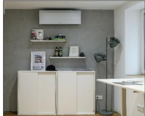
Daikin Emura, Perfera und Stylish sorgen in den einzelnen Räumen für Heizen und Kühlen.
