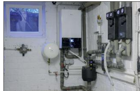
Die Inneneinheit der Daikin Altherma 3 H Wärmepumpe beheizt das Kirchenschiff über die Fußbodenheizung.
