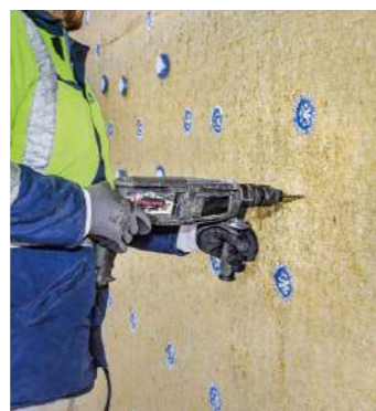
Dämmung von ca. 17.000 m 2 Außenwänden mit dem mineralischen Wärmedämm-Verbundsystem Knauf WARM-WAND Plus in 200 mm Stärke
