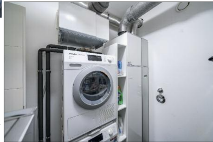
Die kompakte Abluft-Wärmepumpe F750 (rechts) nimmt kaum mehr Raum ein als Waschmaschine und Trockner, über denen das Zuluftmodul platzsparend installiert wurde.
